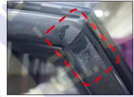
ขัดแล้วรอยแนวเชื่อมสูงค่าเกินมาตรฐาน
