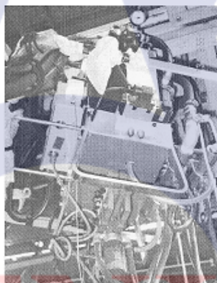
รูปที่ 3.7 Transformer
