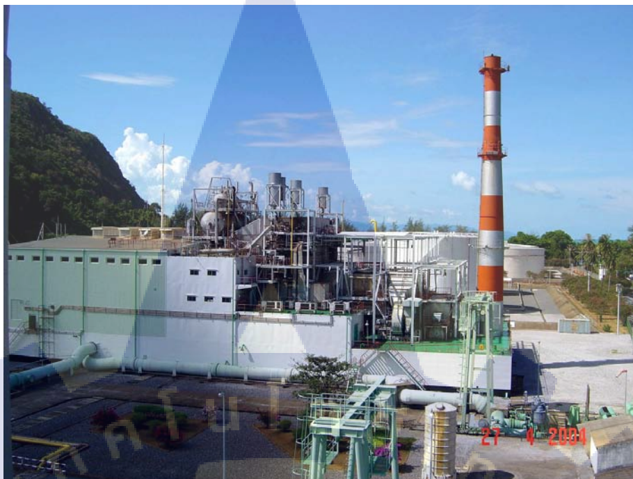
ภาพที่ ข.1 โรงไฟฟ้าพลังความร้อนขนอม ( โรงที่ 1 และ 2 )
