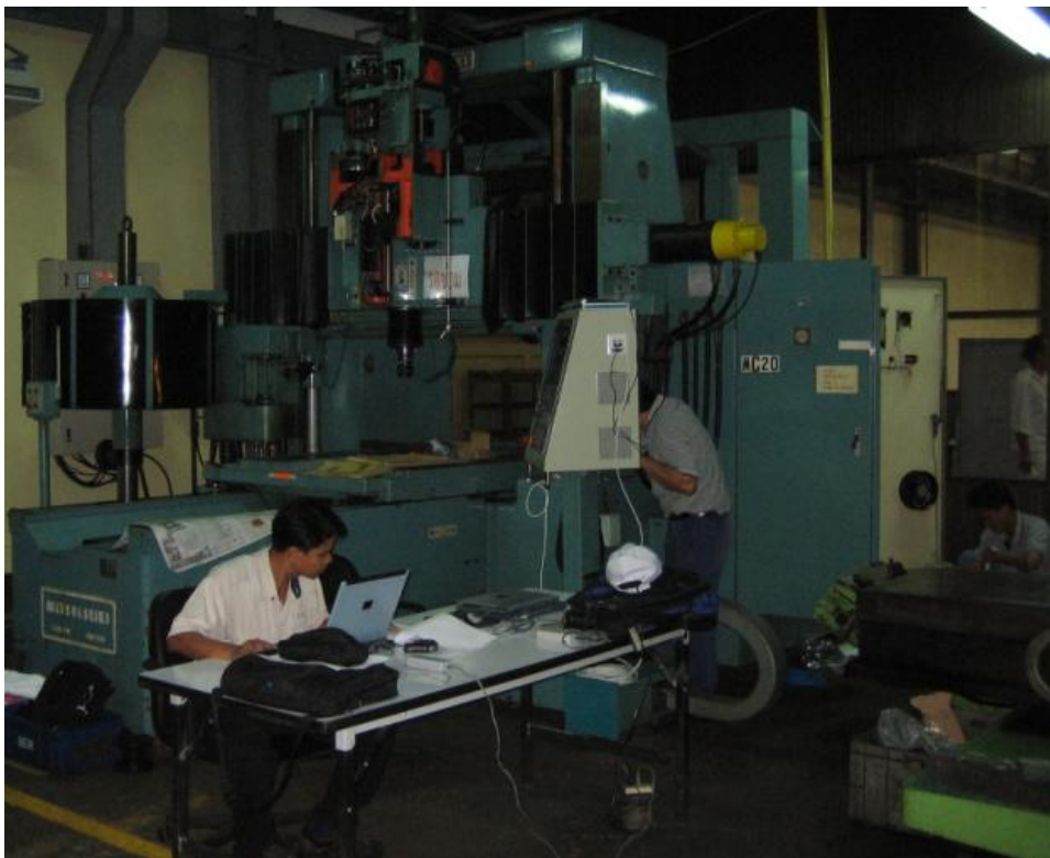
รูปที่ 24 การปรับแต่งพารามิเตอร์ชุดควบคุมและเขียนคำสั่ง PLC
