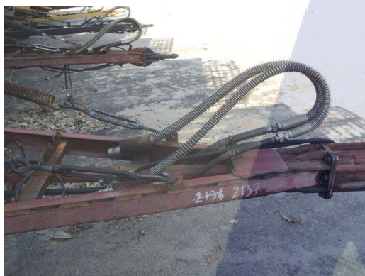
รูปที่ 62 เตินระบบท่อทาง Hydraulic ก่อนปรับปรุง
