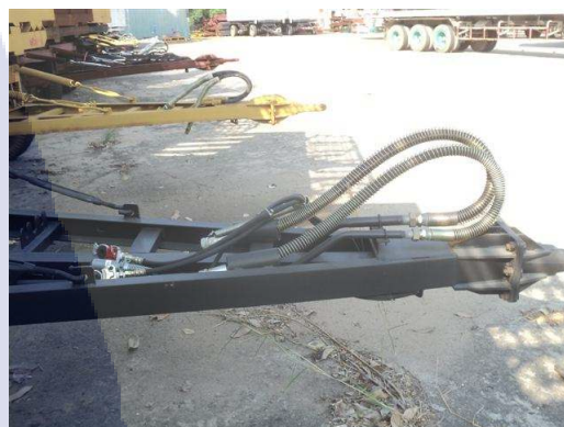
รูปที่ 63 เตินระบบท่อทาง Hydraulic หลังปรับปรุง
