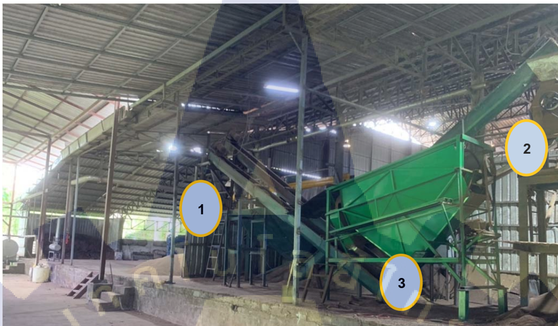
1. กระบะรับกาก 2. เครื่องบดกาก Hammer Mill 3. เครื่องร่อนกากแบบ Rotary Screening
