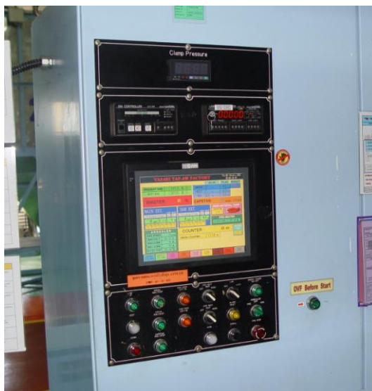
รูปที่ 11 แสดงตัวอย่างอุปกรณ์ควบคุมที่มีการใช้พลังงานในสถานะที่ไม่มีการผลิต
