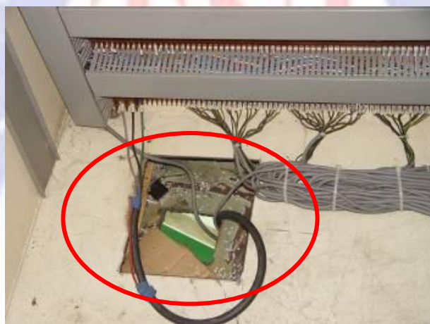
รูปที่ 9 แสดงตู้ควบคุมที่ไม่มีการปิดช่องทางผ่านสายไฟ
