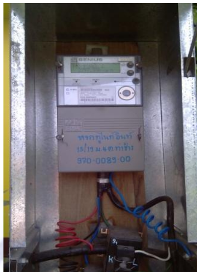
รูปที่ 26 การตรวจสอบสภาพภายนอกของมิเตอร์
