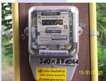
รูปที่ 2 มิเตอร์แบบ 1 เฟส 2 สาย ที่ติดตั้งอยู่ในระบบ
