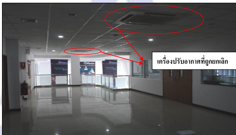
รูปที่ 15 ระบบปรับอากาศชนิดติดฝ้าหรือ Cassette ที่ถูกยกเลิก
