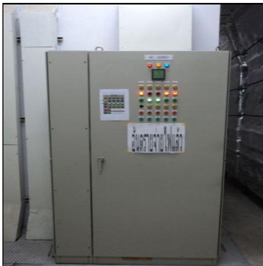
รูปที่ 26 ตู้ควบคุมการทำงานระบบไฟฟ้าของพัดลมระบายอากาศ (Exhaust Fan)
