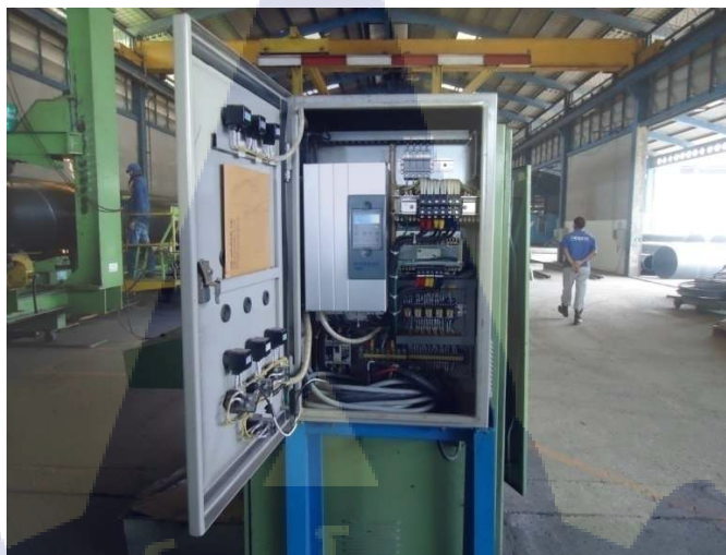
รูปที่ 26 Inverter มีความแม่นยำและติดตั้งใช้แทนชุดเก่า
