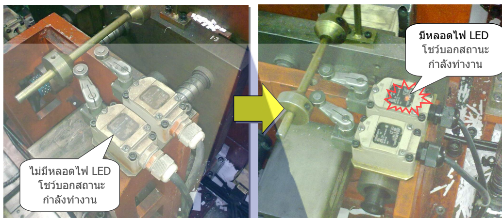
รูปที่ 40 Visual ควบคุมสถานะการทำงานของอุปกรณ์ไฟฟ้า
