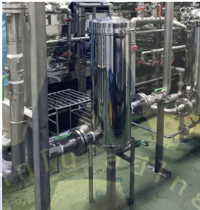
รูปที่ 46 การติดตั้งถังกรองน้ำที่บรรจุไส้กรองความละเอียดในการกรองมากกว่าความละเอียดของไส้กรองที่ใช้ในระบบต้นก้าง ติดตั้งที่จุดใช้งาน
