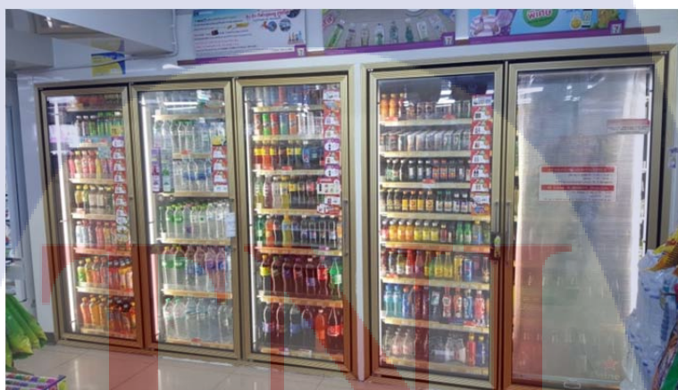
รูปที่ 3.6 ห้องแช่แบบ Walk-in Cold Room
